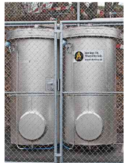
Die Gasfilteranlage. (NRO)
